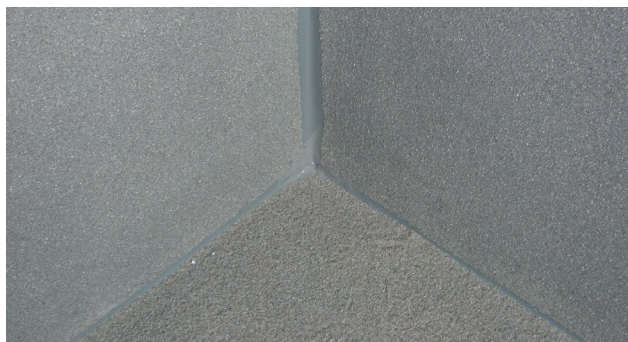
Ingen sanding i bevægelseszoner
