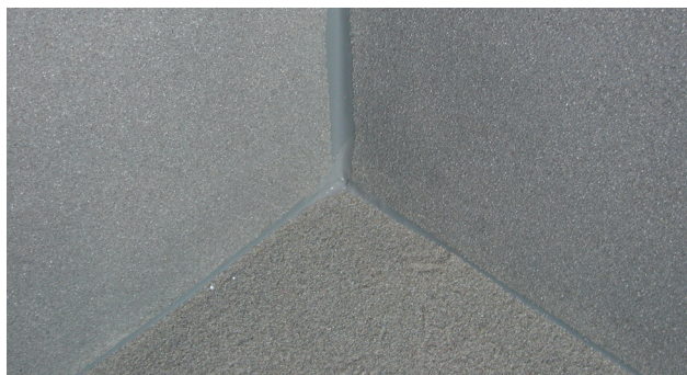
Ingen sanding i bevægelseszoner
